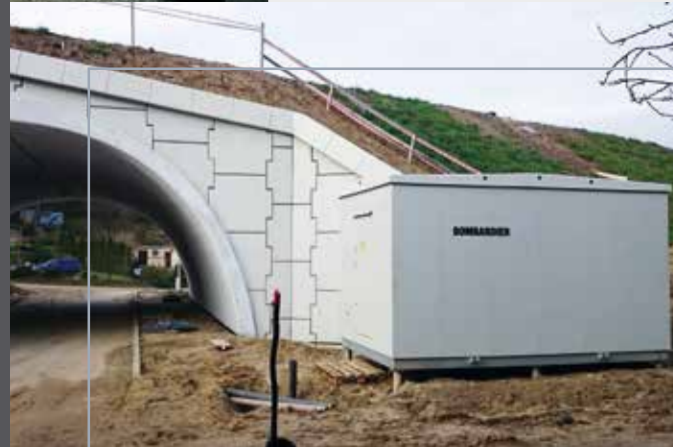
Wzdłuż linii PKM stoją już wszystkie kontenery Bombardiera z systemami SRK dla poszczególnych posterunków ruchu.
